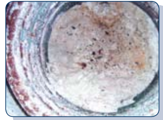
Verkalkter Warmwasserspeicher eines Einfamilienwohnhauses
