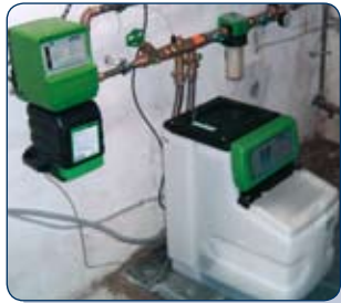
Enthärtungsanlage mit nachgeschalteter Dosierung
