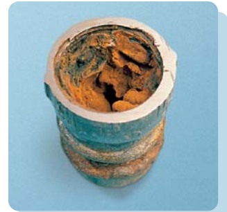
Abbildung F: Brunnenrohr mit starker Eisen- und Manganablagerung
